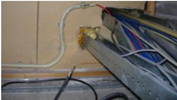
Kabels slecht weggewerkt VROM-inspectie
